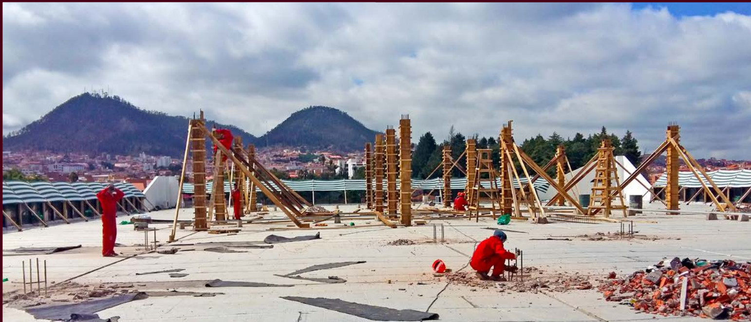
Construcción de cuarto piso del Tribunal Departamental de Justicia de Chuquisaca a cargo de la DAF Nacional
