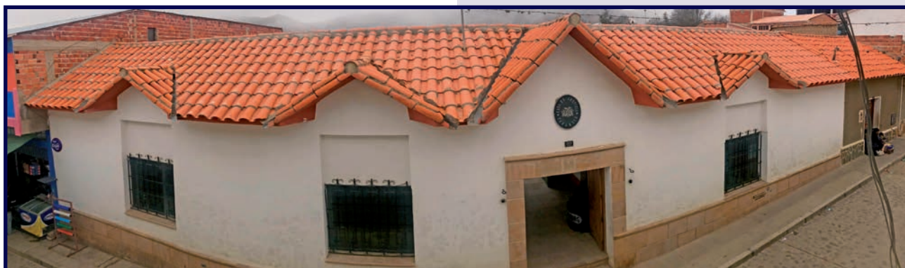
Mejoramiento en la cubierta de teja cerámica de la Casa de Justicia de Tarabuco
